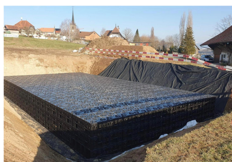
(photo du bac de rétention)
